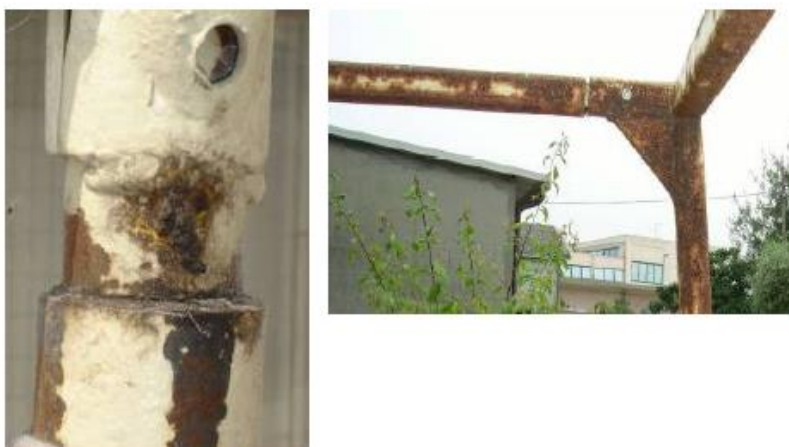
Fig. 2. Esempio di corrosione localizzata (a sinistra) e diffusa (a destra), ma comunque di tipo superficiale, con una riduzione della sezione resistente inferiore al 20%
